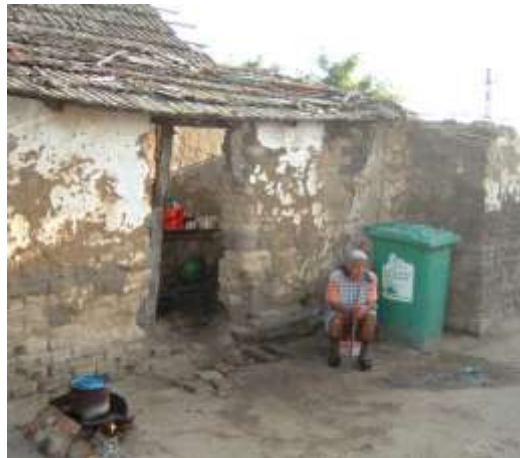
Sandas eingestürztes Haus
