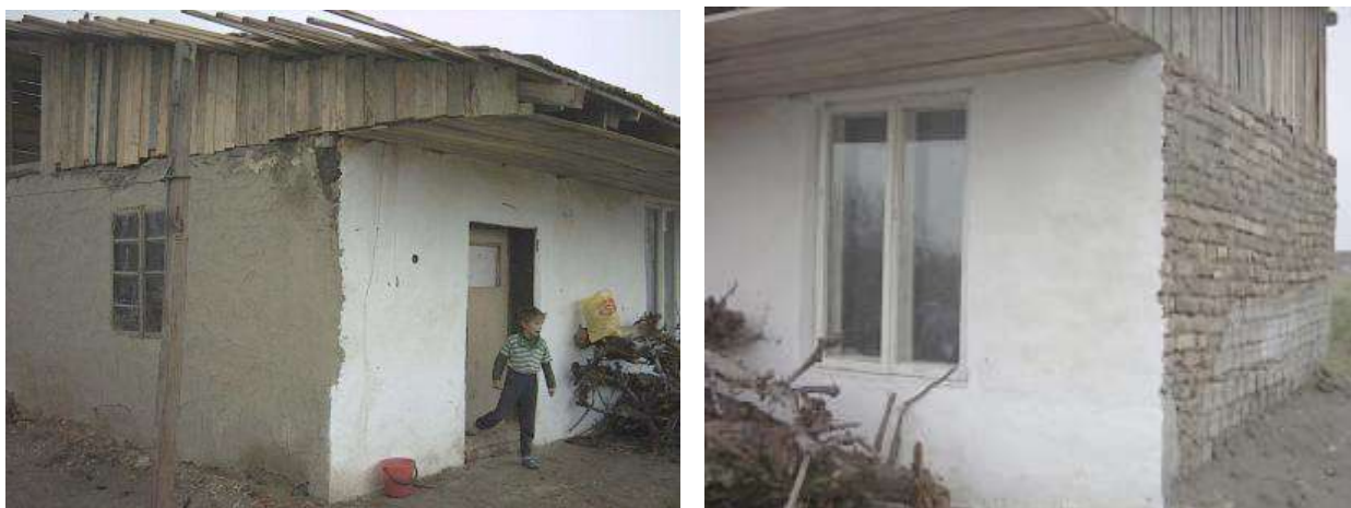
La maison de Sanda avec des murs en briques de glaise et une nouvelle toiture
