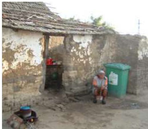
( casa de Sandra, derruida)
