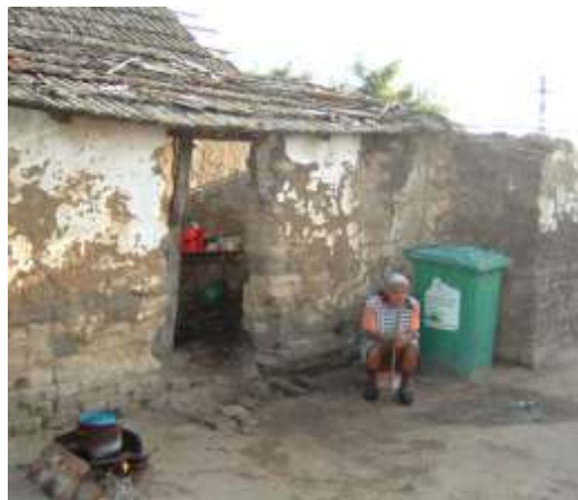
Sandas eingestürztes Haus
